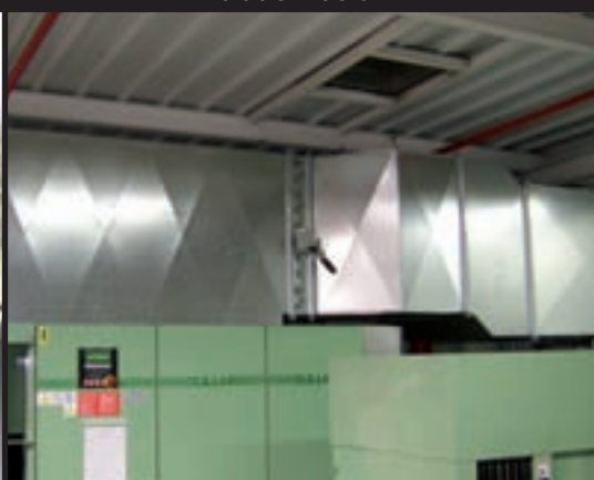
Gainages sur compresseurs
